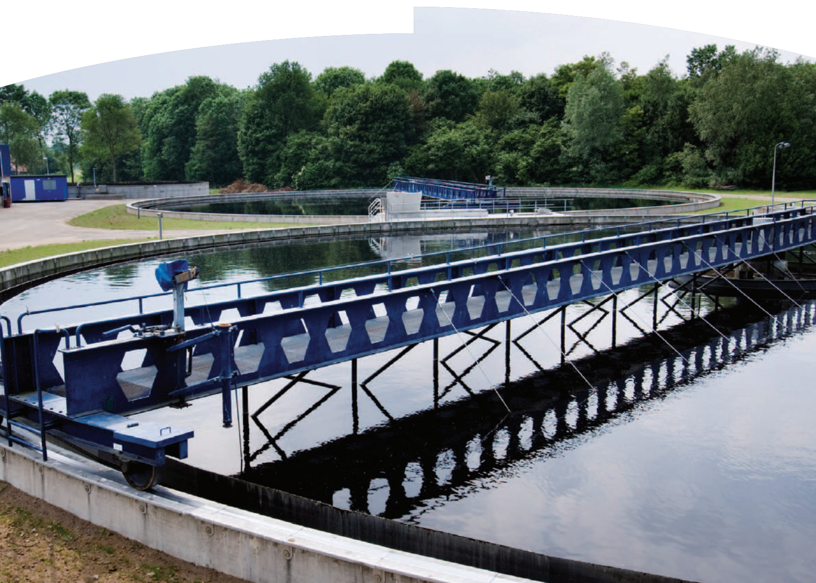
De zorg voor schoon water: waterzuiveringsinstallatie.
